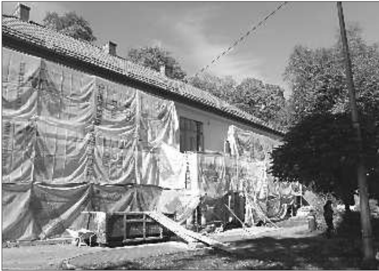
W starym pałacu Potockich dziś swoją siedzibę mają władze miasta. Obecnie trwa tu remont elewacji.
